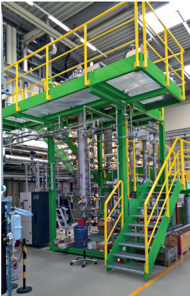
Figure 12: Installation pilote SCCER BIOSWEET (NMT 6) utilisée pour étudier les effets de la pression (jusqu'à 10 bar), des vitesses de gaz et de la taille des particules sur la surface de transfert de masse disponible dans le réacteur de méthanation à lit fluidisé (photo: PSI). Ces connaissances peuvent être utilisées pour améliorer les modèles d'optimisation des réacteurs et les simulations de processus. Les simulations du réacteur seront validées par des expériences dans cette installation.
