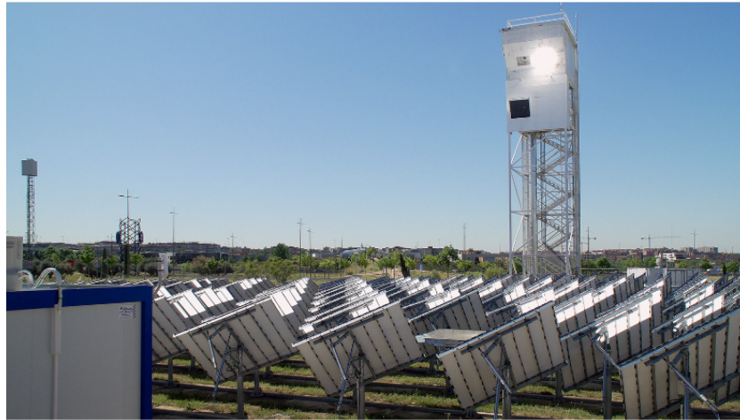
Installation pilote StL, Móstoles, Espagne (photo : Christophe Ramage ©ARTTIC 2019)
